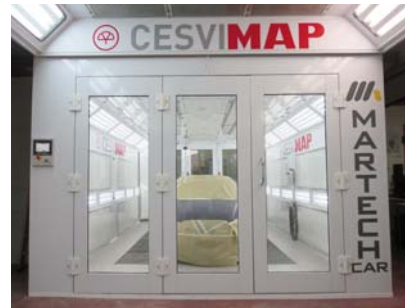
Interior de la cabina de pintura
